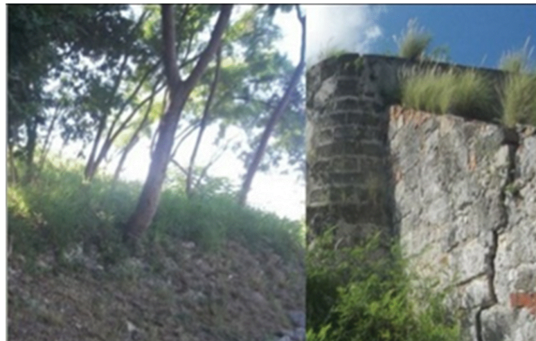
Figura 17. Movimiento lento de tierra del castillo de Atarés, Habana Vieja: arboles inclinados y agrietamiento de muros y paredes. Foto de Cantillo-Rodríguez et al. ,(2017).
