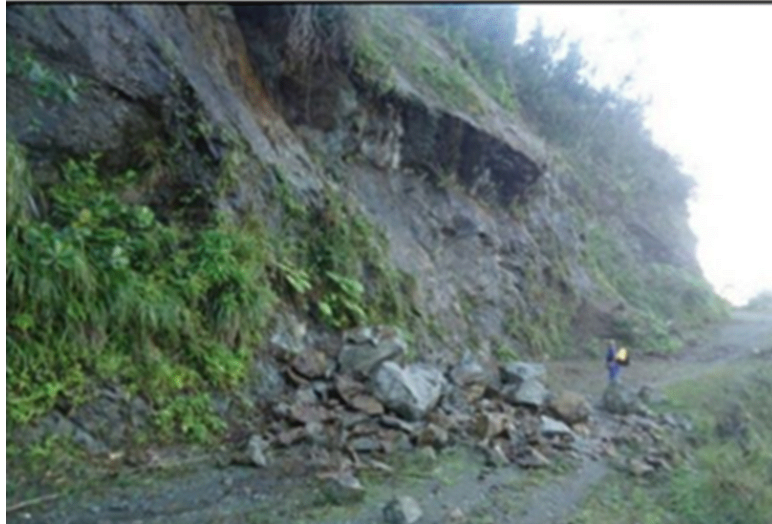
Figura 8. Desprendimiento de rocas ofiolíticas obstruye la Vía Mulata, entre Viento Frío y Quiviján provincia Guantánamo. Foto tomada por Pérez-Aragón. (2018).
